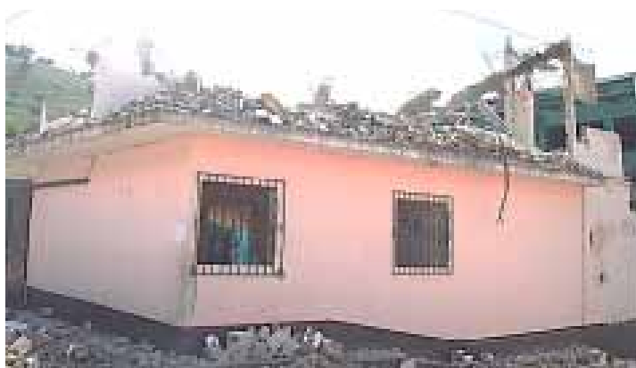
Figura 08. Colegio colapsado en horas de clase.
