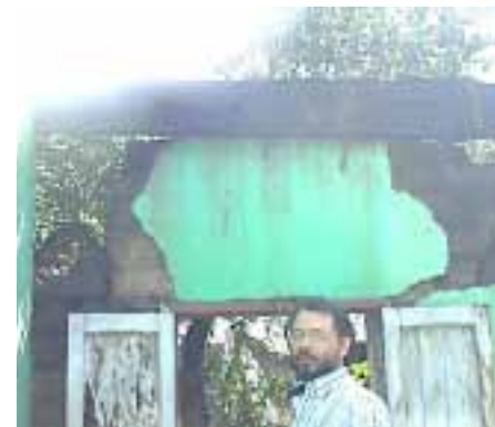
Figura 09. Observación de daños en una vivienda de adobe colapsada.
