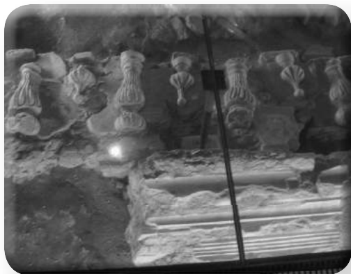
Restos del parapeto de la fachada.
