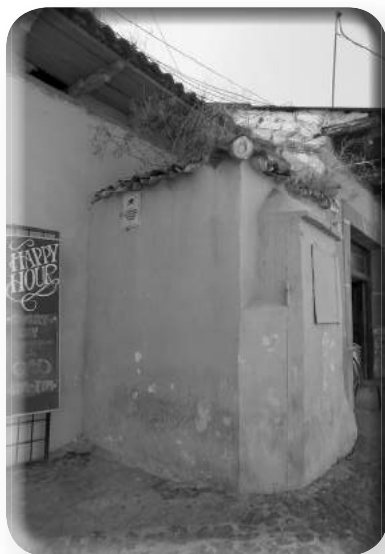
Caja de distribución de agua.
