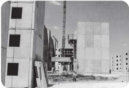
Figura 7 Proceso constructivo de Nimajuyú II, hacia mediados del decenio de 1990. Fotografía: anónima
